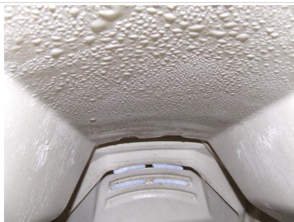
Obr. 4. Kondenzace vzdušné vlhkosti na stropu a vnitřních površích VIB
