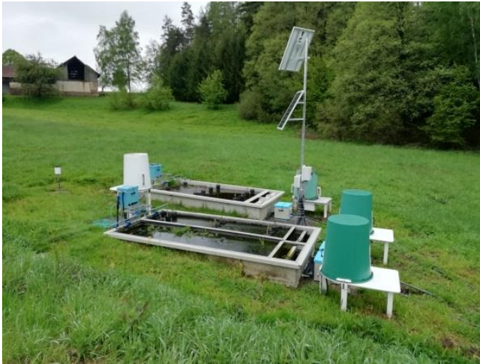
Obrázek 4: Instalované pilotní bioreaktory s automatickým monitorovacím a řídicím systémem
