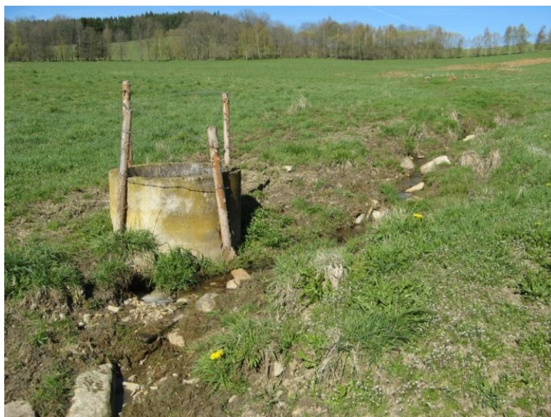
Obr. 2.3.1.1. Poškozený objekt odvodnění a nedostatečně řešené okolí na pastvině. Vyšebrodsko. Foto: P. Fučík
