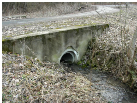
Obrázek 10.4.4 Trubní propustek na lesní cestě ze ŽB trub, přímé vtokové čelo z betonu / ŽB - autor: Karel Zlatuška
