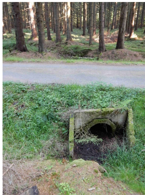
Obrázek 10.4.6: Trubní propustek na lesní cestě z betonových trub osmibokých, přímé vtokové čelo ze ŽB prefabrikátů - autor: Karel Zlatuška
