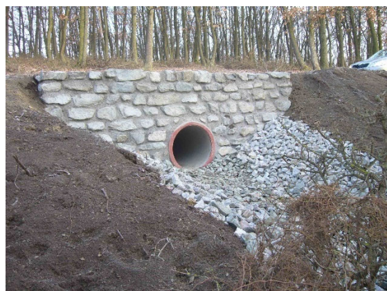
Obrázek 10.4.12: Trubní propustek na lesní cestě ze ŽB trub, přímé výtokové čelo ze zdiva z lomového kamene na maltu cementovou s vyspárováním, spadiště z kamenného záhozu bez úpravy líce doplněný o pohoz z drceného kameniva - autor: Karel Zlatuška
