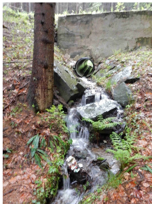
Obrázek 10.4.16 Trubní propustek na lesní cestě z plastové korugované trouby, přímé výtokové čelo z betonu / ŽB, erozí poškozené spadiště z kamenné rovnaniny, následně sanované těžkým kamenným záhozem (bez urovnání líce) - autor: Karel Zlatuška
